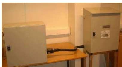
Cabina TEC conectada a cabina de trafo simulada
